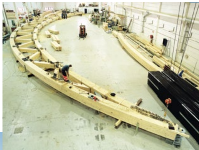
Her bearbejdes en limtrekonstruksjon til Tynset bru hos Moelven, en av de dominerende aktørene innen treindustrien i Hedmark og Oppland. Foto: Moelven.
