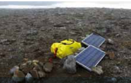
Instrumentpakke og solpanel for ett av de 13 arrayelementene på Bjørnøya. Foto: Johannes Schweitzer
