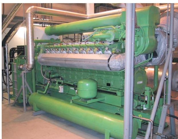
Bilde av gassmotorene på Klemetsrud. Foto: Johs Bjørndahl
