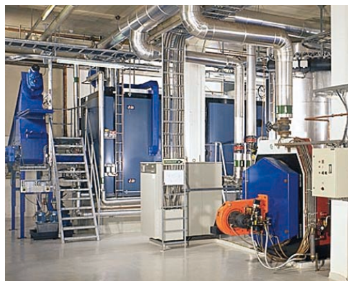
Brikettkjel (bak) erstatter oljekjelene (foran) på Sogn videregående skole
